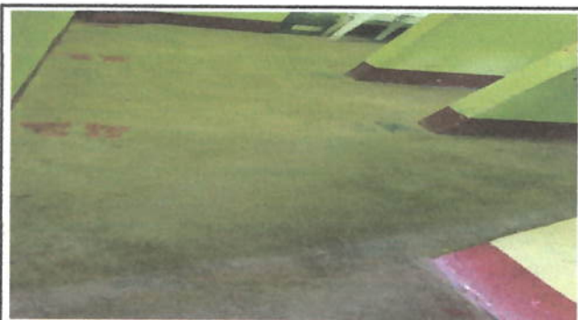
Foto 3: PISO EN MAL ESTADO ✓
