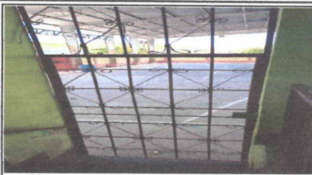
Foto 2: PORTON EN MAL ESTADO
